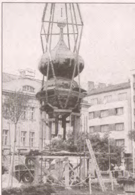
Věž mladoboleslavského kostela sv. Jana Nepomuckého je po opravě umisťována na původní místo. Koule pod špicí obsahuje pozdrava s poselstvím příštím generacím (k článku dole na této stránce)
