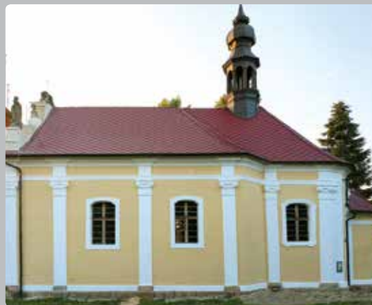
Vikariát lounský: Široké Třebčice, kostel Povýšení sv. Kříže - obnova střechy a fasády
